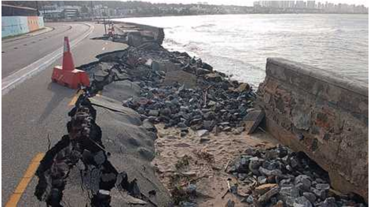
Figura 137. Fortíssimo processo erosivo em frente a hotel em construção (Fonte: autor).
